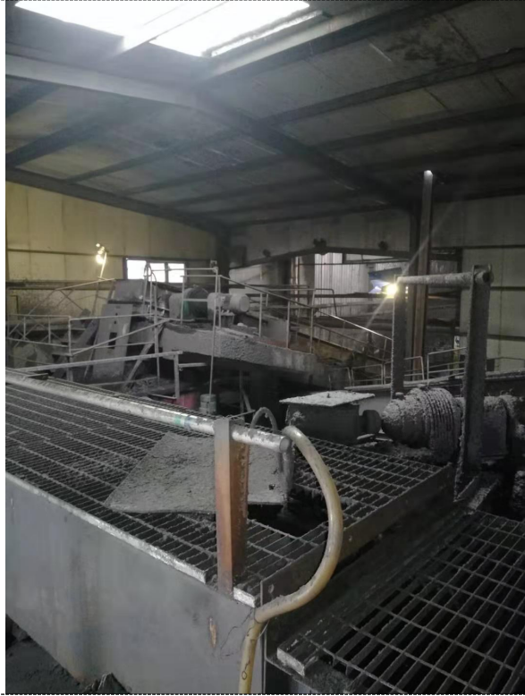
煤泥输送泵房
